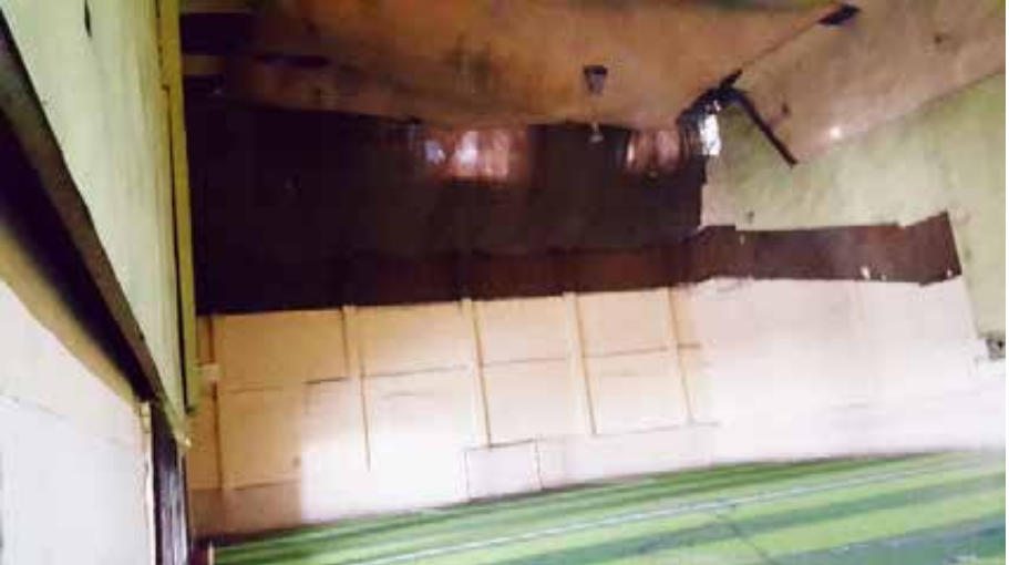
Şekil 7: Sökülmüş balkon ve loca bölümleri.
