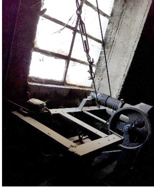
Şekil 18: Tavandaki açılır kapanır pencere ve mekanizma.
